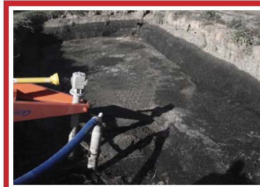
▲ Trabajando aspirando solo barro
